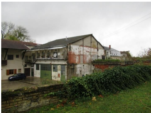
Figure 14 : un des bâtiments de la fromagerie, plus récents que l'aile Sud, et très abimé. Inclus dans le tracé, car jointif avec la friche industrielle.
