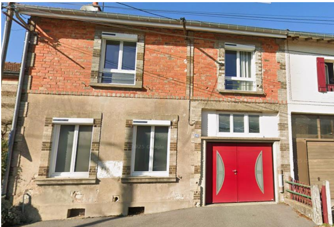
Figure 19 caissons de volets roulants et menuiseries non adaptées au bâti à l'architecture traditionnelle (streetview ; 2025)
